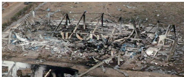
图 12 建筑物 C 破坏情况 Fig.12 Damage of building C
