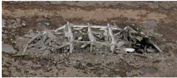
图 11 建筑物 B 破坏情况 Fig.11 Damage of building B
