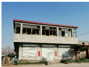
图17 沙荡村破坏情况
